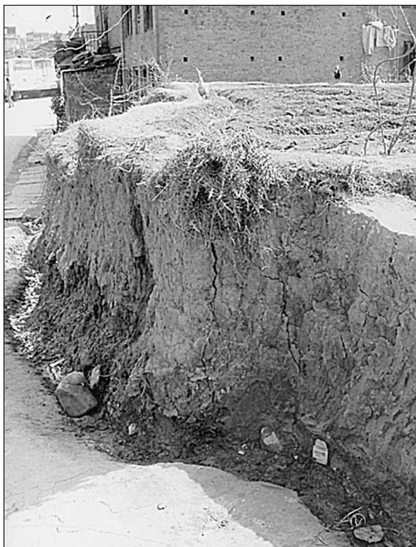
Растрескивание рыхлого грунта с образованием зияющих трещин.
